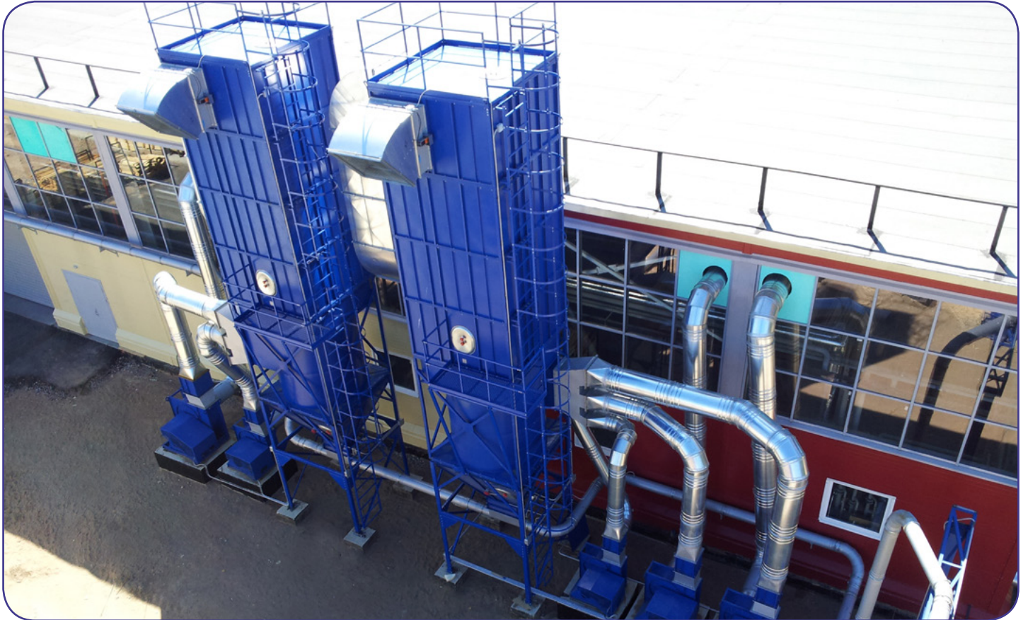
Система аспирации L= 96 000 м3/час. Рукавные фильтры с вибровстряхиванием ФР-32 - 3 шт. Домостроительный комбинат "Энергия", Ленинградская обл., пос. Пушное
