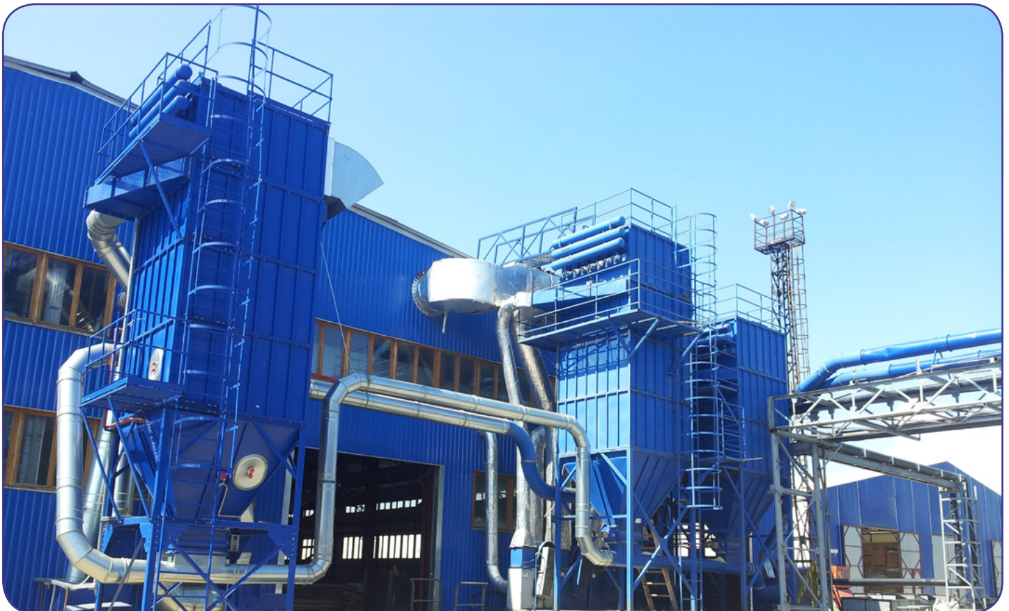
Система аспирации L= 67 000 м 3 /час. Рукавные фильтры с импульсной продувкой ФРИ-32 - 2 шт., ФРИ-20 - 1 шт. Компания ЗОДЧИЙ, г. Бронницы
